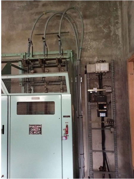
Anciens transformateurs HT et TGBT
