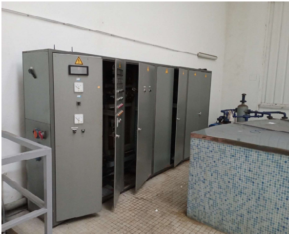
Ancienne armoire électrique
