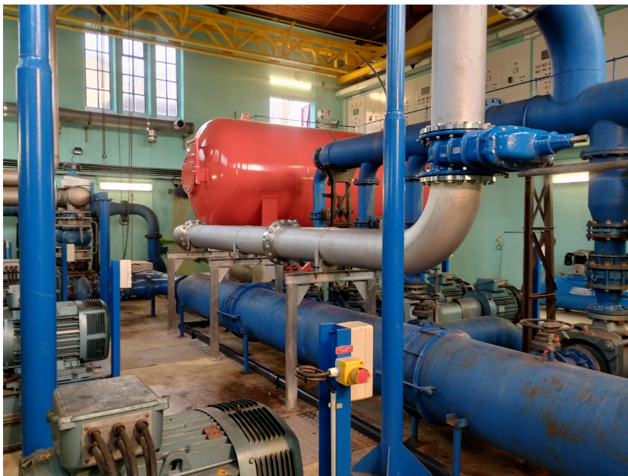
Ballon anti-bélier de 17 m 3 avec sa tuyauterie de raccordement au réseau
